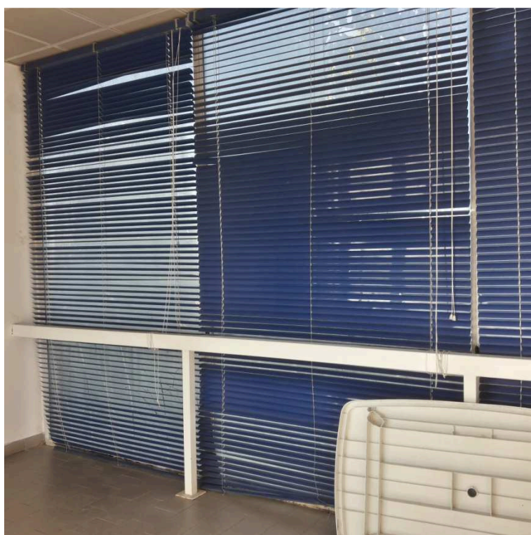
Foto 10 Dettaglio specchiature infissi P1 da sostituire (vista interna)
