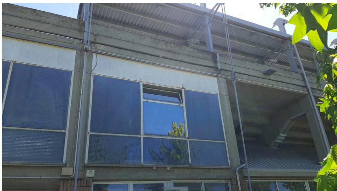
-Foto 3 Dettaglio parapetto dislocato e danneggiamenti soletta bordo , impianti illuminazione esterni da spostare, pluviali e tiranti tergalì
