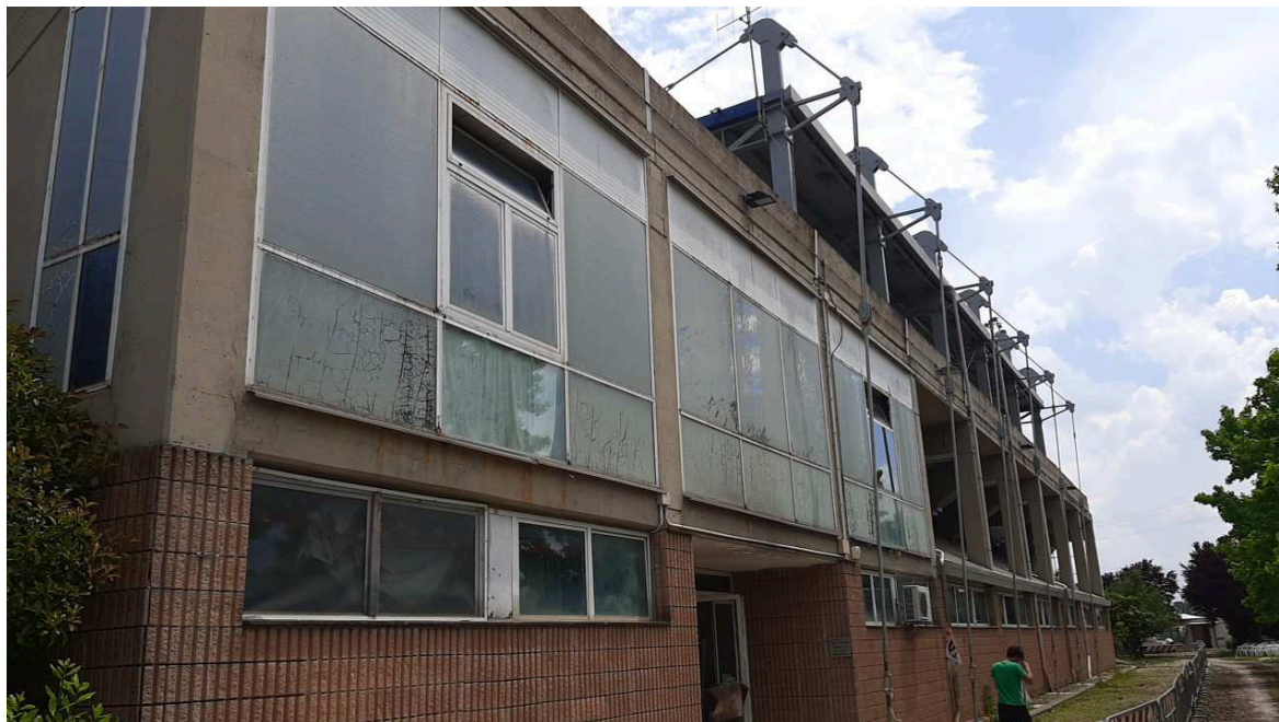
Foto 9 Dettaglio specchiature infissi P1 da sostituire (vista esterna)
