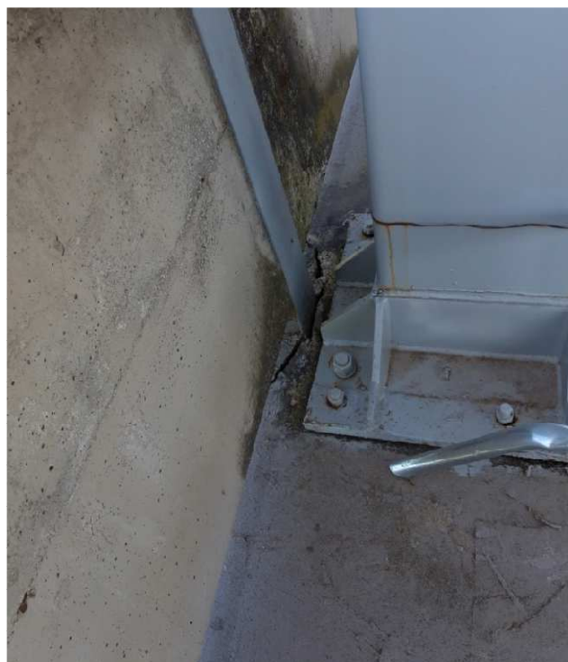
Foto 4 Dettaglio montante parapetto dislocato
