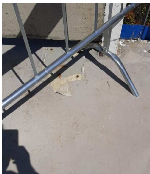
Foto 8 Dettaglio ammaloramento rivestimento soletta tribune
