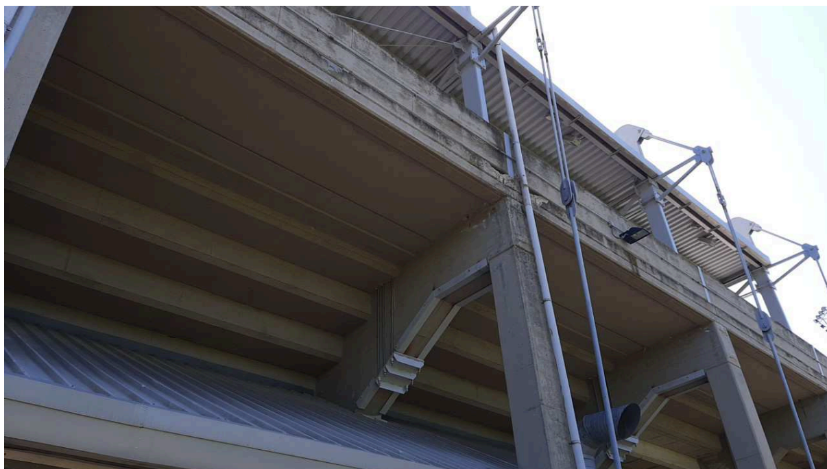
Foto 2 Dettaglio parapetto dislocato e danneggiamenti soletta bordo , impianti illuminazione esterni da spostare, pluviali e tiranti tergali
