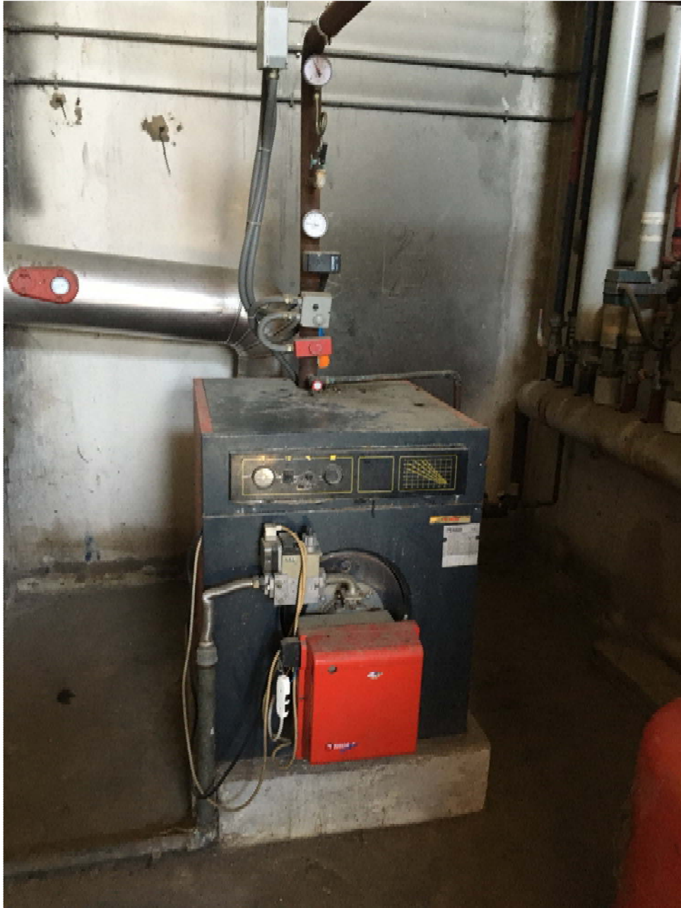
Foto del Generatore e sicurezze Cantiere Vecchio
