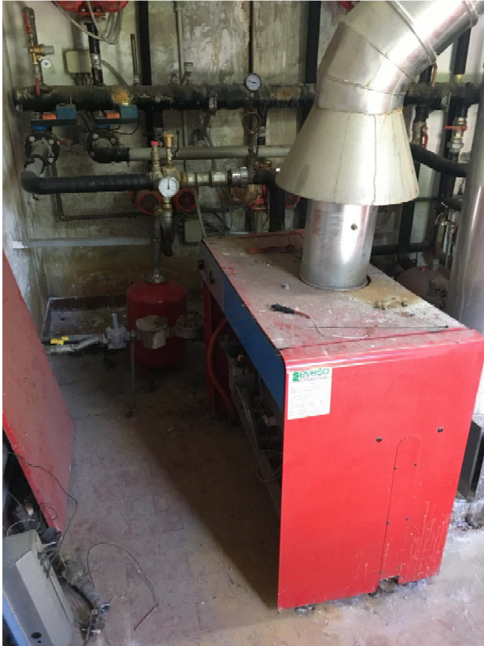
Foto del Generatore e sicurezze Cantiere Nuovo
