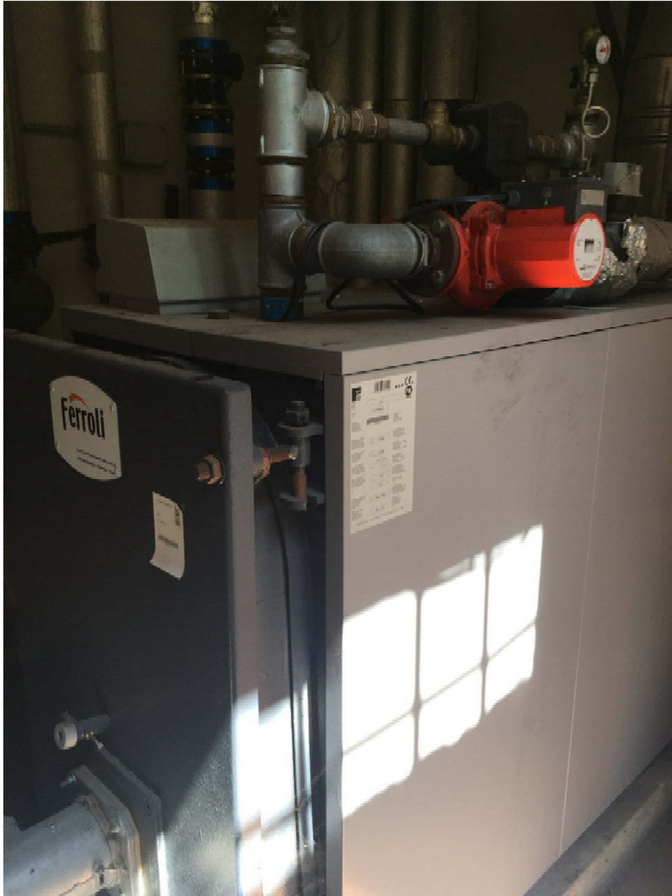
Foto Generatore Villa Montalvo
