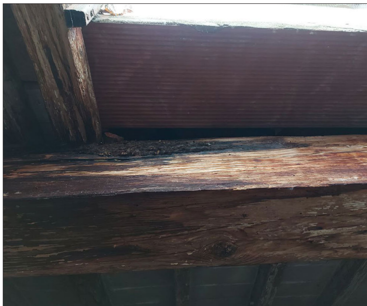
Documentazione fotografica relativa al lucernario aperto recentemente sulla copertura e ai problemi di infiltrazione ad esso legati
