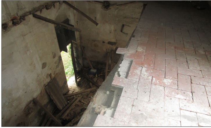
Porzioni di solaio crollate all'interno degli ambienti minori
