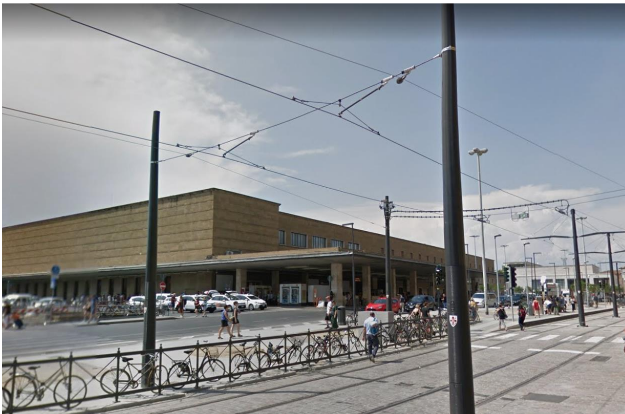
Figura 8 – Soluzione tipologica per la sospensione dei fili di contatto (sospensione trasversale sorretta da pali laterali)
